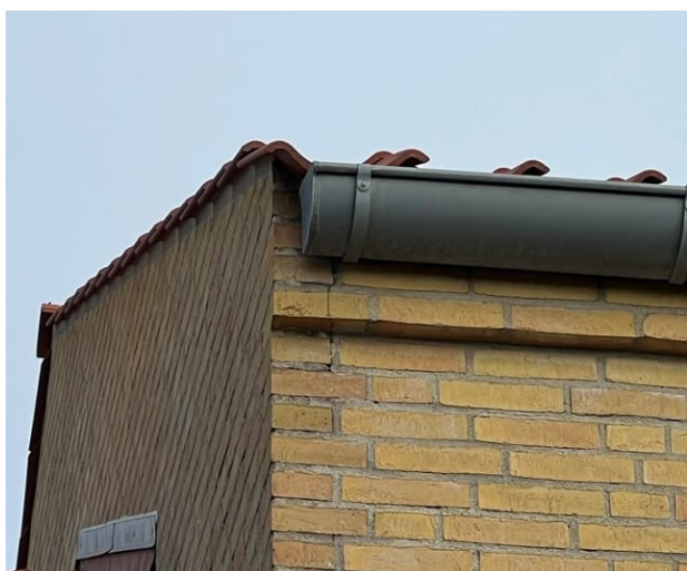
Nr 9 mod havnen, murværk er utæt/revnet
