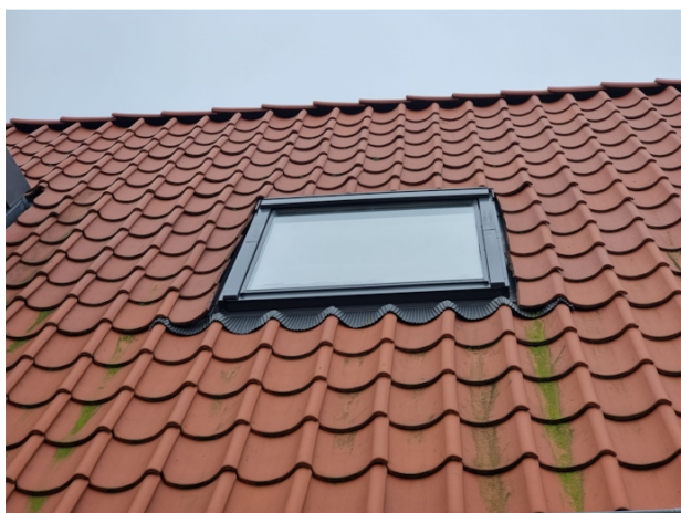
Bløde inddækninger har rejst sig lidt
